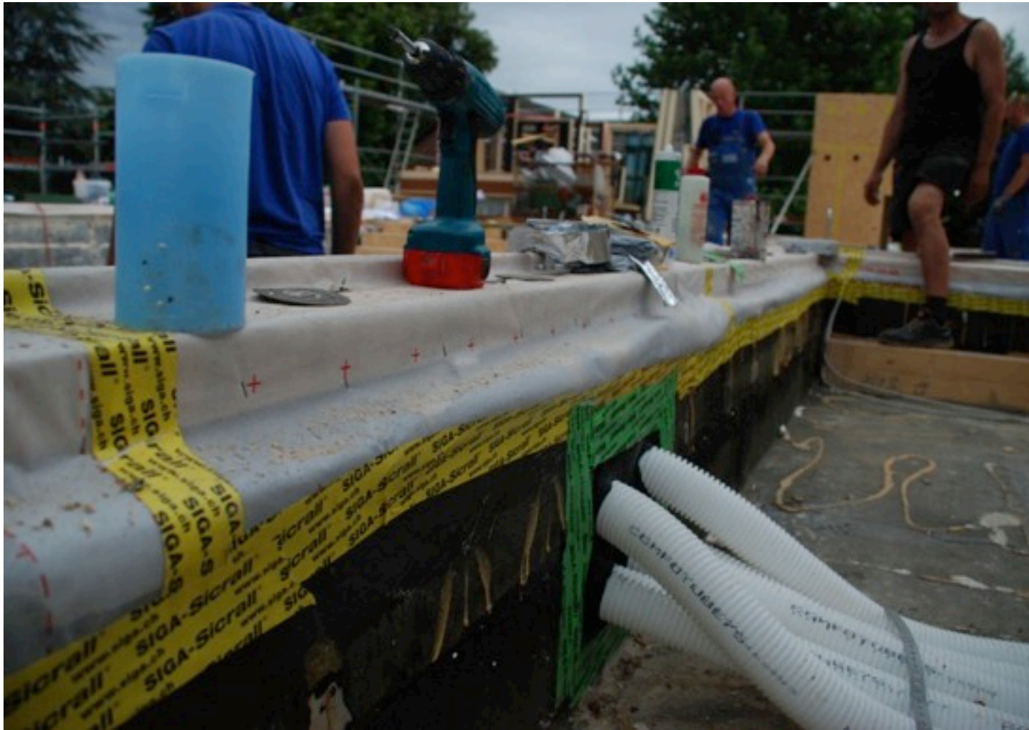
break-throughs ??? Betonattika Verteilerkasten mit Einzelrohren Abluft
